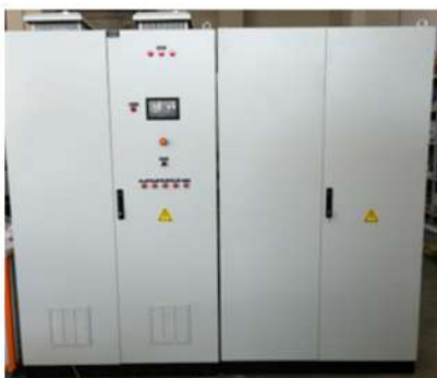
Jet Fan Automation Panel
